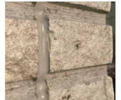
コーキングの劣化予防
